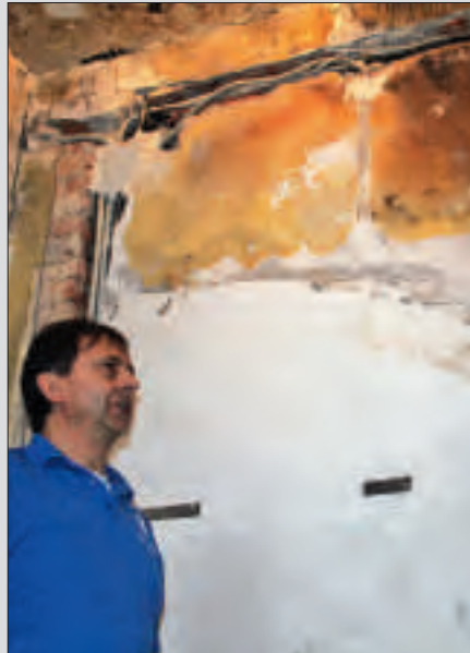
Dr. Norbert Karl steht im beschädigten Treppenhaus.
